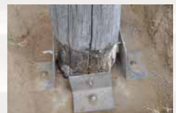
腐食した柱根
